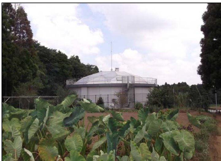
【調整水槽のアルミニウム合金製ドーム屋根】
