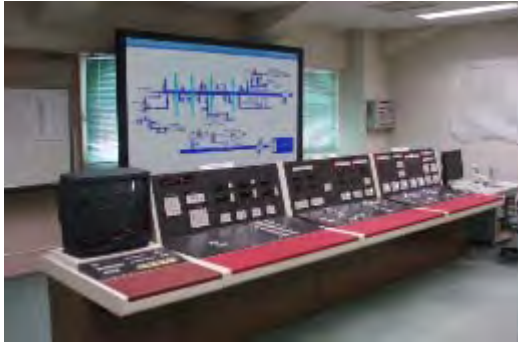
▲ 中央管理センター：管理室
