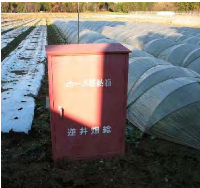
【畑地帯総合整備事業で設置された防火用水施設】
