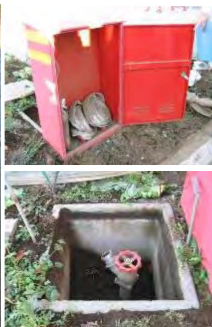
【ホースの接続が可能な給水栓】
