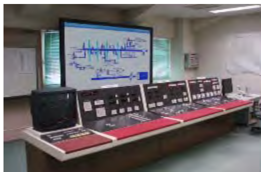
▲ 中央管理センター：管理室
