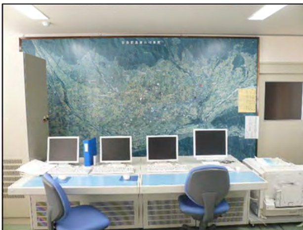
【排水管理システム】
