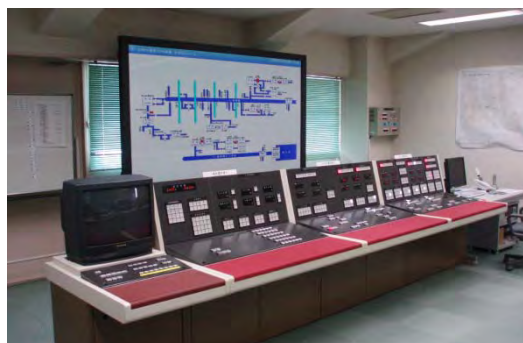
▲ 中央管理センター：管理室
