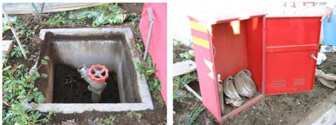
【県営事業で整備された給水栓と消防用ホース】
