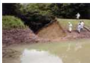
台風の影響で決壊したため池
