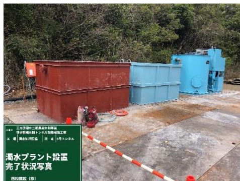
写真 濁水処理施設
