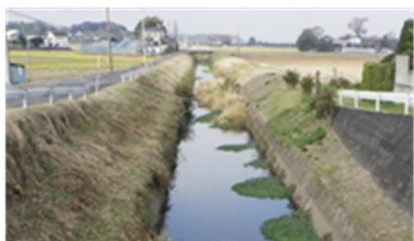
水路での繁茂
