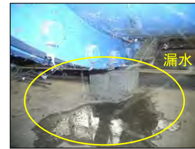
ポンプ設備からの漏水
