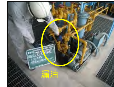
ポンプ設備からの油漏れ
