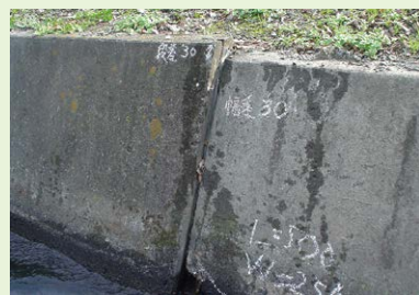
用水路の継目に段差
