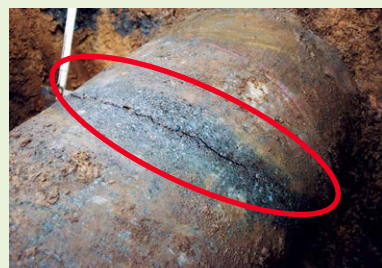
埋設管のひび割れ
