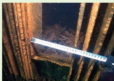
玉淀ダムスクリーン部の破損
