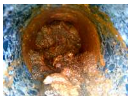
コア内部状況
