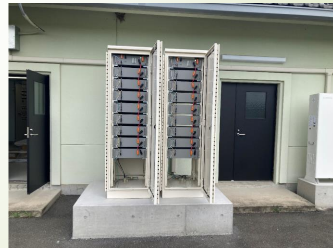
蓄電池 20kW h × 2
