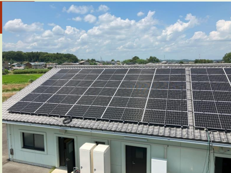
太陽光パネル
