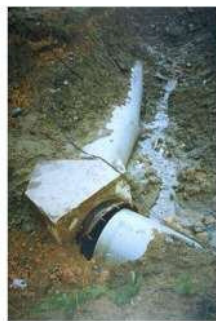
図-9.6.36 スラストブロック部の管路の 離脱状況（北海道南西沖地震）
