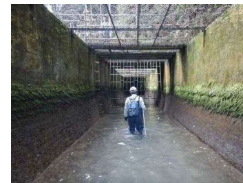
断水時の滞水状況
