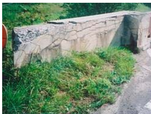
写真 凍害によるスケーリング
