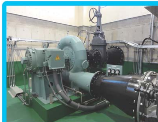
小水力発電(199kW)
