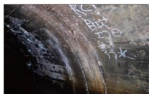
川上2号トンネルエフロ、漏水状況
