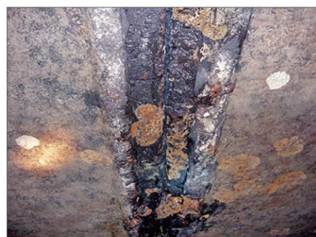
前河原伏越 目地の劣化状況(整備前)
