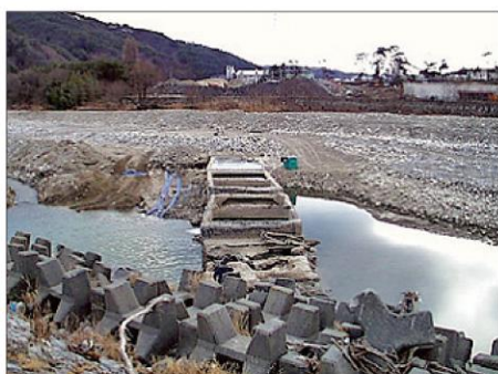
天竜川伏越 破断状況(整備前)
