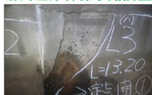
第3号開渠のコンクリート剥離状況
