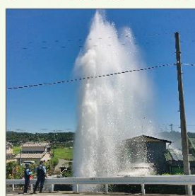
腐食した空気弁からの漏水
