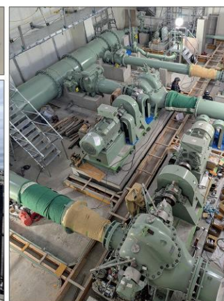
ポンプ設備 据付状況
