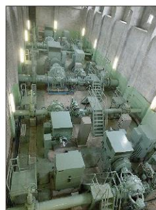
牧之原揚水機場
