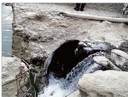
天竜川伏越 破断状況(整備前)
