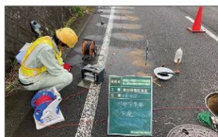
中央幹線7号空気弁 (管対地電位測定状況)
