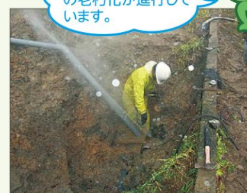
幹線水路(鋼管)の腐食による漏水
