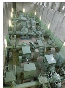
牧之原揚水機場
