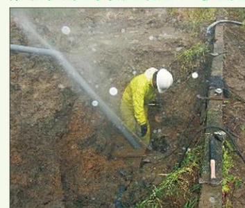
幹線水路(鋼管)の腐食による漏水
