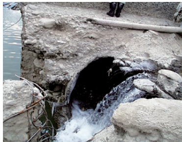
破損状況写真（破損部分）
