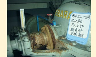
ポンプ軸受けの腐食
