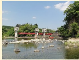
西岩崎頭首工(耐震不足)
