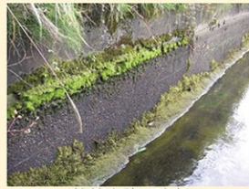
幹線水路の摩耗
