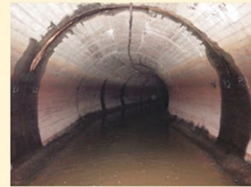
トンネルの漏水
