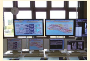
監視操作設備
