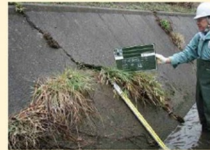
幹線水路のひび割れ
