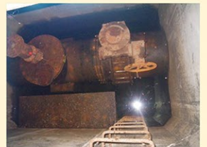
バルブの腐食
