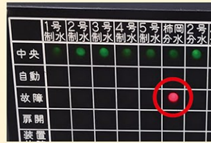
操作卓(故障表示)
