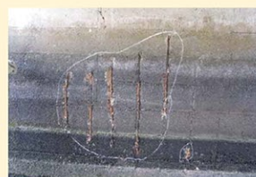
開水路の鉄筋露出
