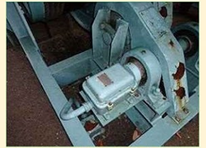
ゲート設備の塗装劣化
