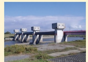
邑楽頭首工（耐震不足）
