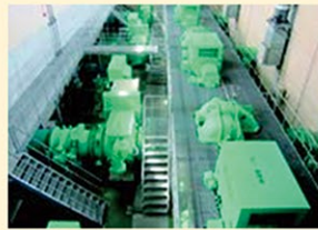
第3揚水機場（ポンプ設備）
