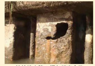
幹線排水路の鋼板腐食孔
