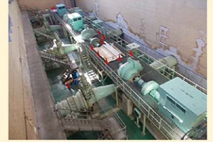
第2揚水機場（ポンプ設備）
