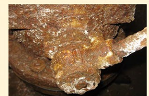
バルブの発錆
