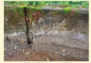
水路の摩耗、ひび割れ
