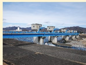
太田頭首工（耐震不足）
