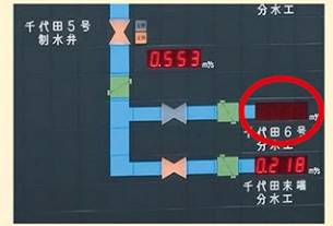
操作卓(故障中)
