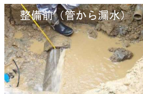
整備前(管にクラック)
