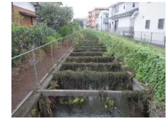
流下能力が不足している排水路
