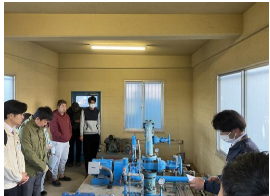
上大谷揚水機場視察
