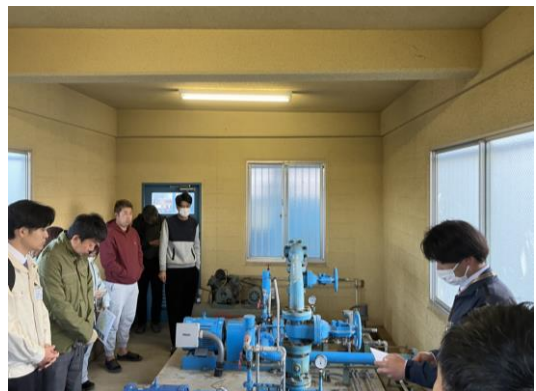
上大谷揚水機場視察
