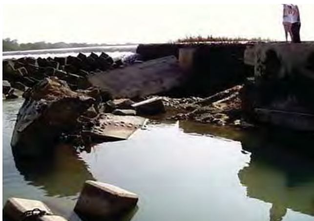
【江南サイホンの被災状況】 (平成10年)
