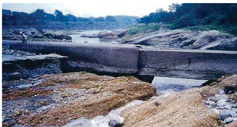
【河床低下により露出した 江南サイホン(事業実施前)】
