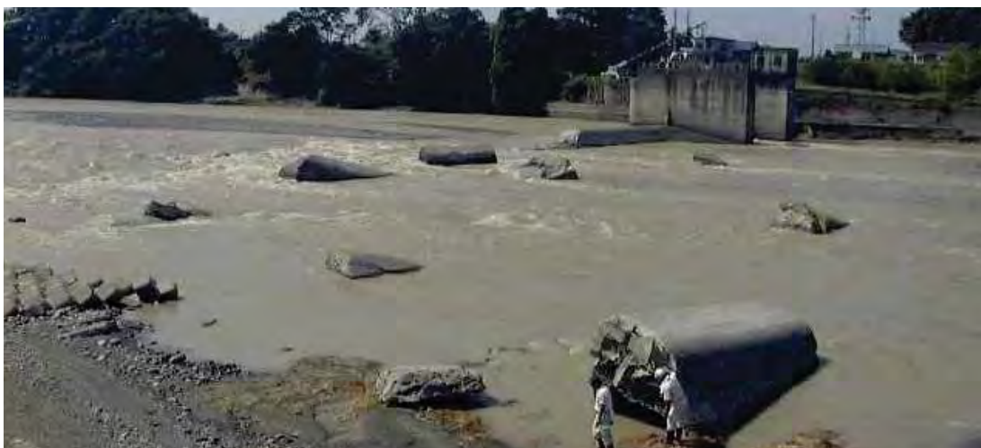
【平成 11 年 8 月の降雨に伴う洪水により旧六堰頭首工が倒壊】
