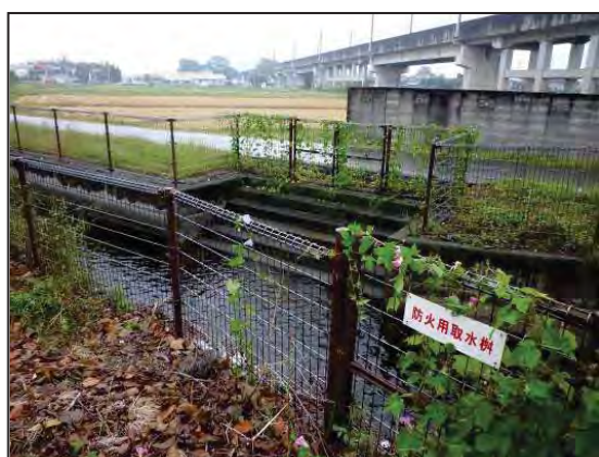
【水路に設置された防火用取水桧】
