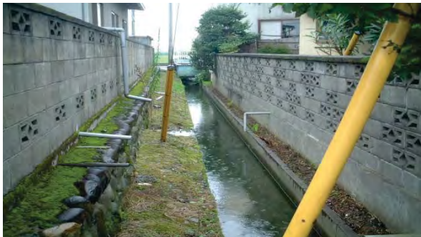
【改修前の家庭雑排水流入状況(代堀)】
