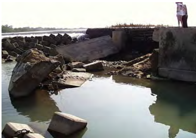
【江南サイホンの被災状況】 (平成10年)
