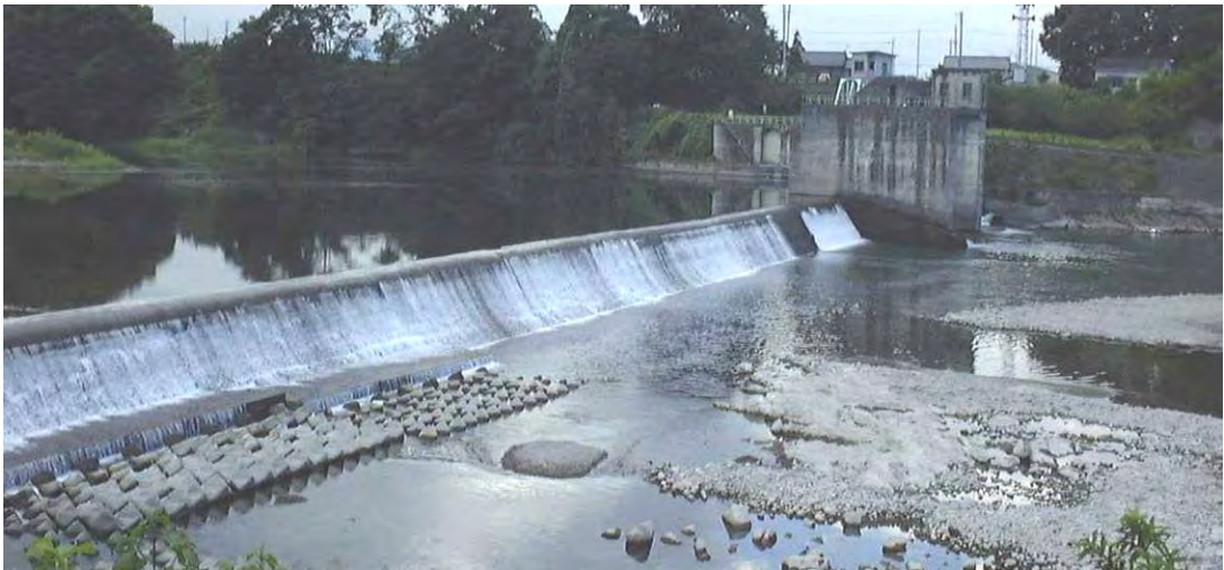
【旧六堰頭首工(約 1mの河床低下により堤体下流部が露出)】
