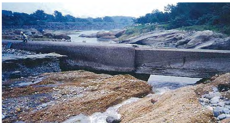
【河床低下により露出した 江南サイホン(事業実施前)】
