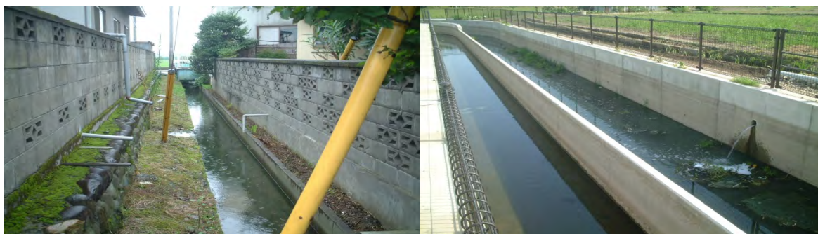
【改修前の家庭雑排水流入状況(代堀)】
