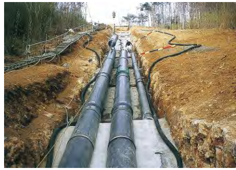
左側：小宅送水路、中央：小宅幹線 右側：小宅吐水槽の吐水吐管
