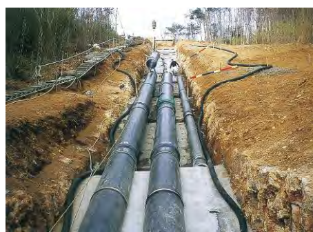
左側：小宅送水路、中央：小宅幹線 右側：小宅吐水槽の吐水吐管
