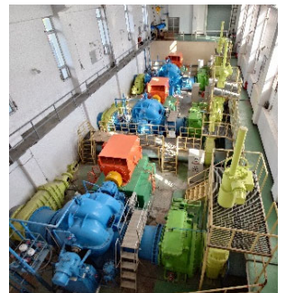
ポンプ設備（改修後）
