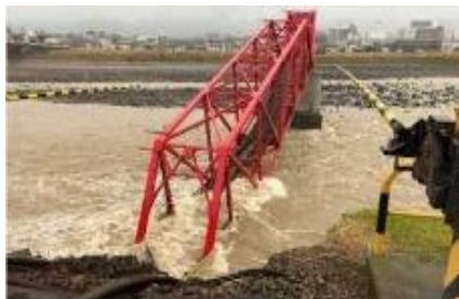
長野県上田市 橋梁が倒壊し、 鉄道が不通となりました。
