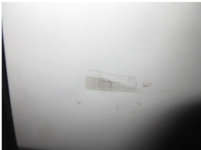
①-1 ①の上部傷箇所
