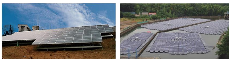
調整池敷地内や貯水池水面を利用した太陽光発電 【左：那須野ヶ原地区(栃木県)、右：北総中央地区(千葉県)】
