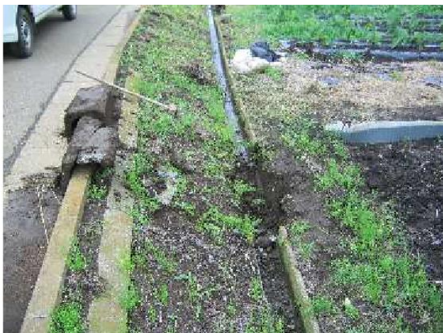
破損したU字溝を確認
