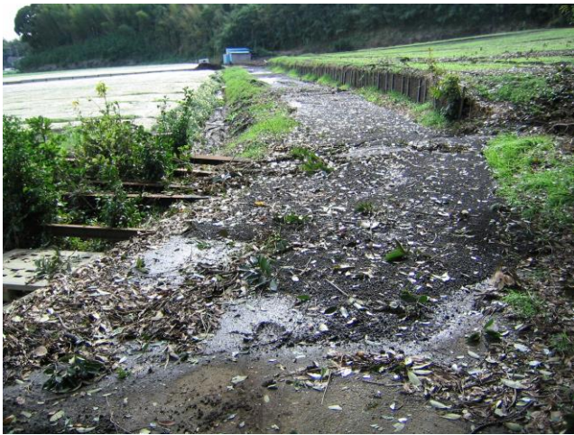
農道に堆積した土砂を確認
