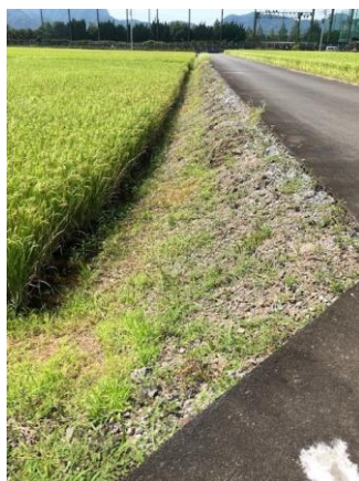
未対策の路肩
