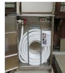
（易操作性1号消火栓）
