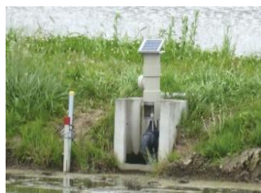
水管理システム WATARAS（ワタラス）
