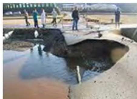
【管の破裂による道路陥没】
