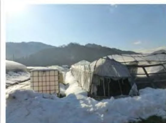
積雪によるビニールハウス倒壊(兵庫県豊岡市)
