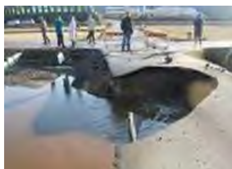
【管の破裂による道路陥没】
