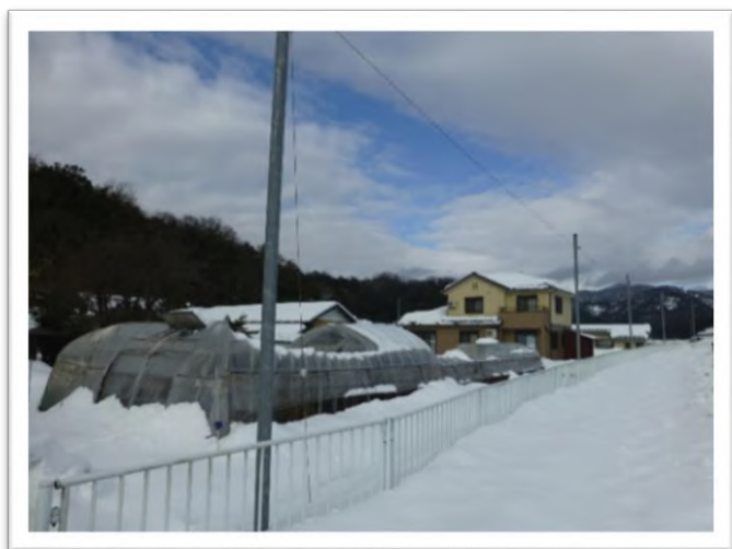
積雪によるビニールハウス倒壊(京都府南丹市)
