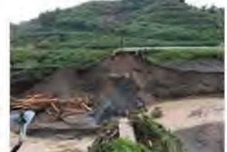
平成29年7月の豪雨により決壊(福岡県)
