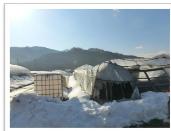
積雪によるビニールハウス倒壊(兵庫県豊岡市)
