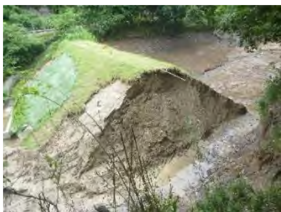
図表－1 平成30年7月豪雨で決壊したため池（京都府塩津古池）
