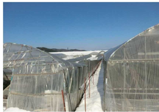
積雪によるビニールハウス倒壊(兵庫県豊岡市)
