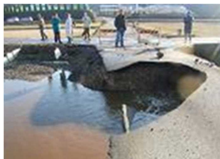
【管の破裂による道路陥没】
