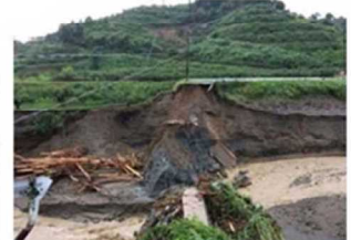
平成29年7月の豪雨により決壊(福岡県)
