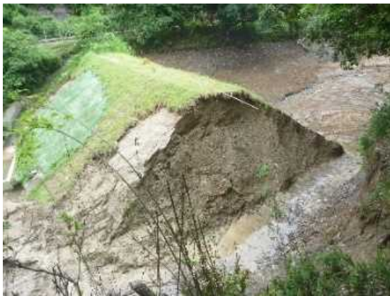
図表－1 平成 30 年 7 月豪雨で決壊したため池（京都府塩津古池）
