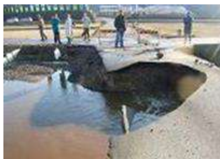
【管の破裂による道路陥没】
