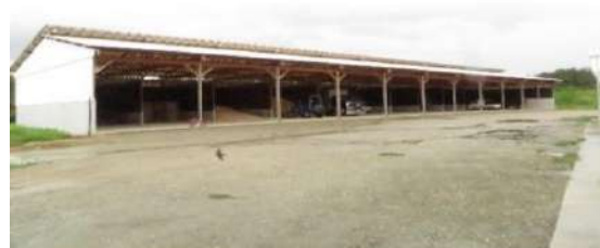
畜産クラスター事業で整備した堆肥舎
