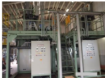
農業集落排水施設の整備
