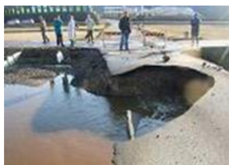
【管の破裂による道路陥没】
