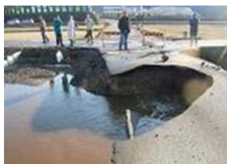
【管の破裂による道路陥没】
