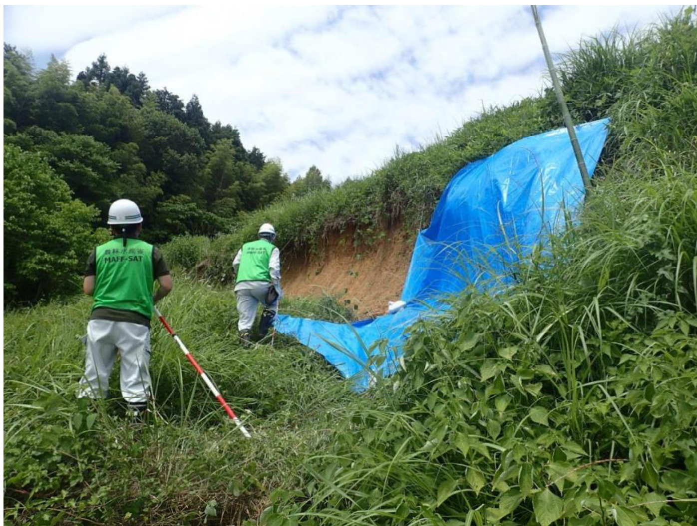
6月豪雨後のMAFF-SATによる 和歌山県内ため池被災調査
