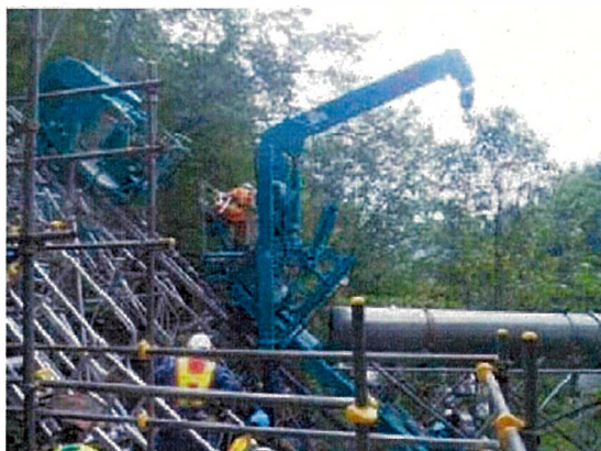
写真. 配管状況
