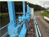
取水口ゲート （開閉装置腐食）
