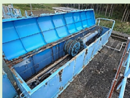
土砂吐ゲート （開閉装置腐食）
