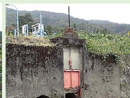
排水ゲート （全体腐食）
