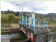
制水ゲート （機側操作盤老朽化）
