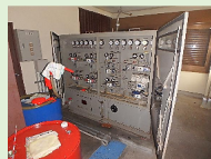
洪水吐ゲート （油圧ユニット油漏れ）
