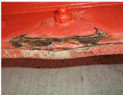
頭首工ゲートの発錆、 水密ゴムの変形
