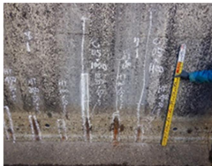
水路の鉄筋露出
