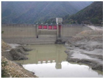
堤体付近の堆砂状況
