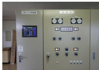
蒲生頭首工 TM/TC子局装置 (国造施設)
