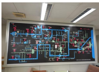
中央管理所 監視盤 グラフィックパネル
