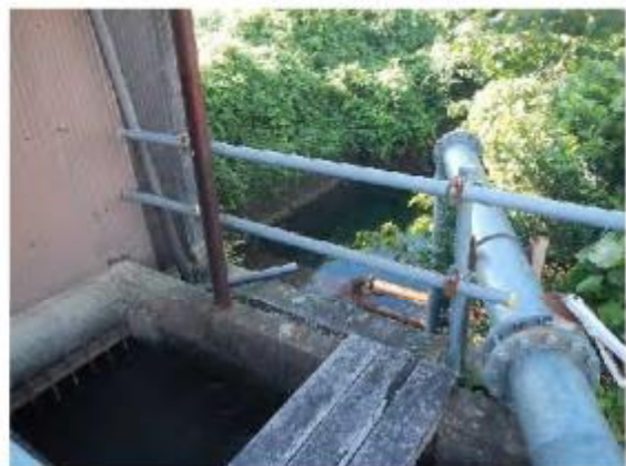
集水井 (上羽田北方団地)
