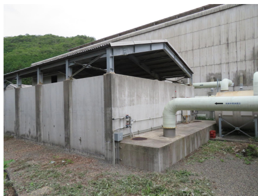
ロックウール脱臭槽で各発酵槽からの臭気を回収・脱臭
