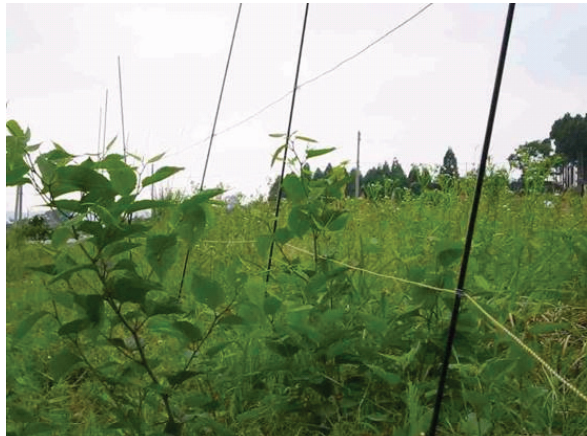
写真61. 草が接触して漏電（滋賀県）
