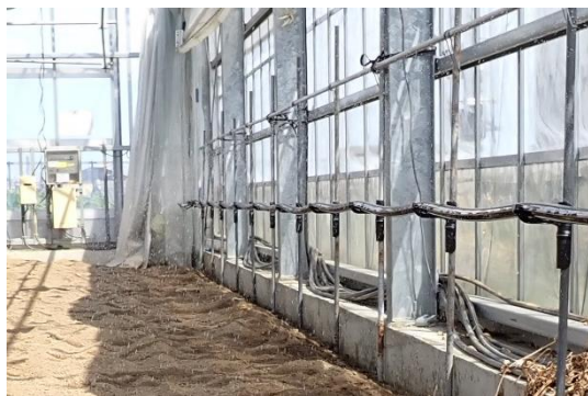
ハウスサイドに設置した灌水チューブ
